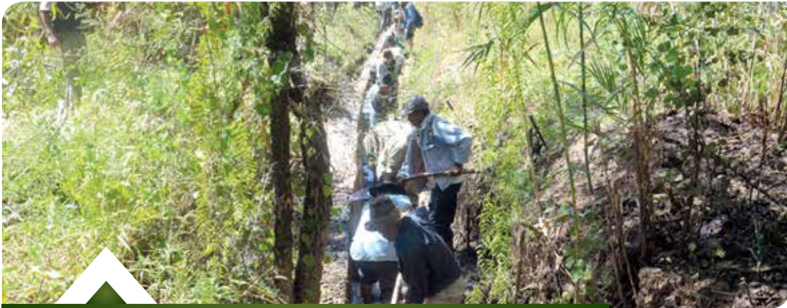
Im Rahmen des Klimawandels sind eine gemeinsame Vision und gemeinsam durchgeführte Arbeiten unabdingbar. Foto: Bewässerungsgemeinschaft bei Instandhaltungsarbeiten für das Bewässerungssystem (in Selbstverwaltung). Saipina, Santa Cruz. (2012)
