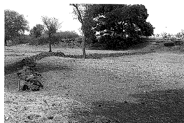
Photo 90 Petite digue filtrante dans un bas-fond du Sanmatenga (Projet DRS/EAA, 1985).
