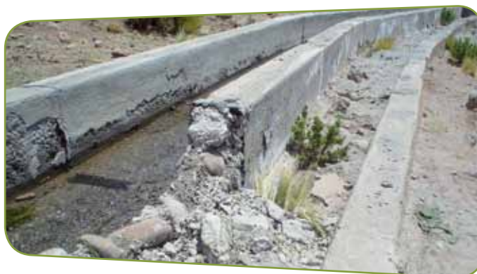
Canal desmoronado por deficiencias en la construcción.
