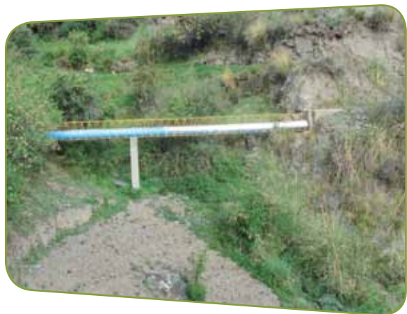
Acueducto que atraviesa deslizamiento de ladera
