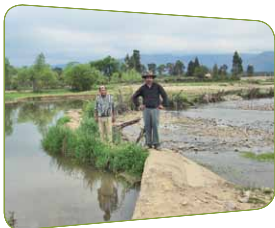
Conducción de la obra de toma en Tolomosita
