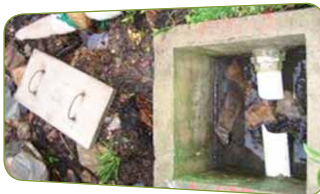
Robo de válvulas
