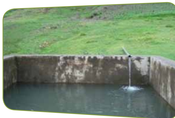
Estanque del sistema de riego
