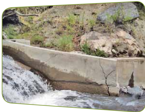
Rajaduras en la obra de captación en Palca
