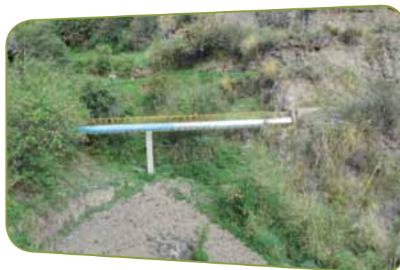
Sifón para cruce de quebrada
