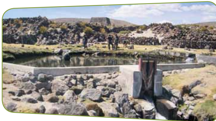
Obra para captación del agua de vertiente
