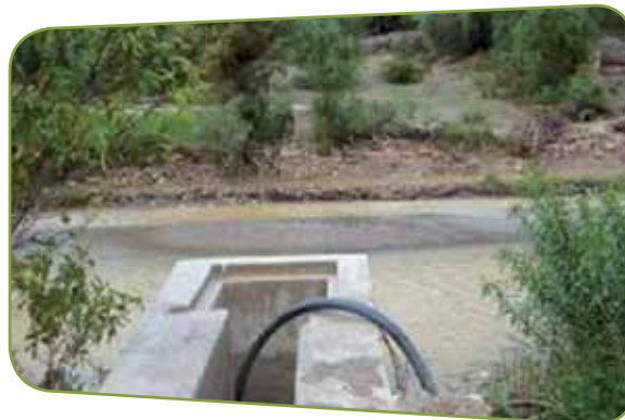
Zona del sifón colapsado
